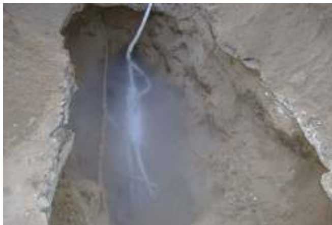
SLIKA 1 – Zamrzavanje oštećene žile kabla
