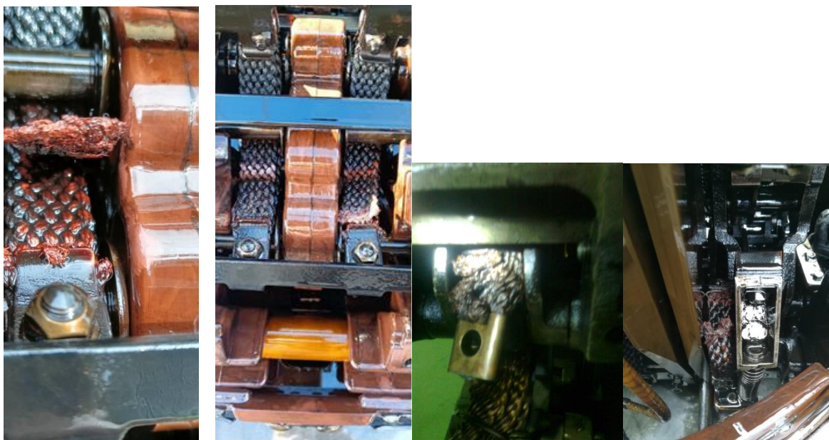
Slika 8 – Oštećenja i prekidi bakarnih pletenica
