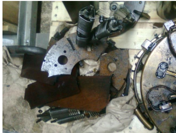
Slika 3 – Električnim lukom oštećeni prelazni otpornik prekidačkog dela RS
