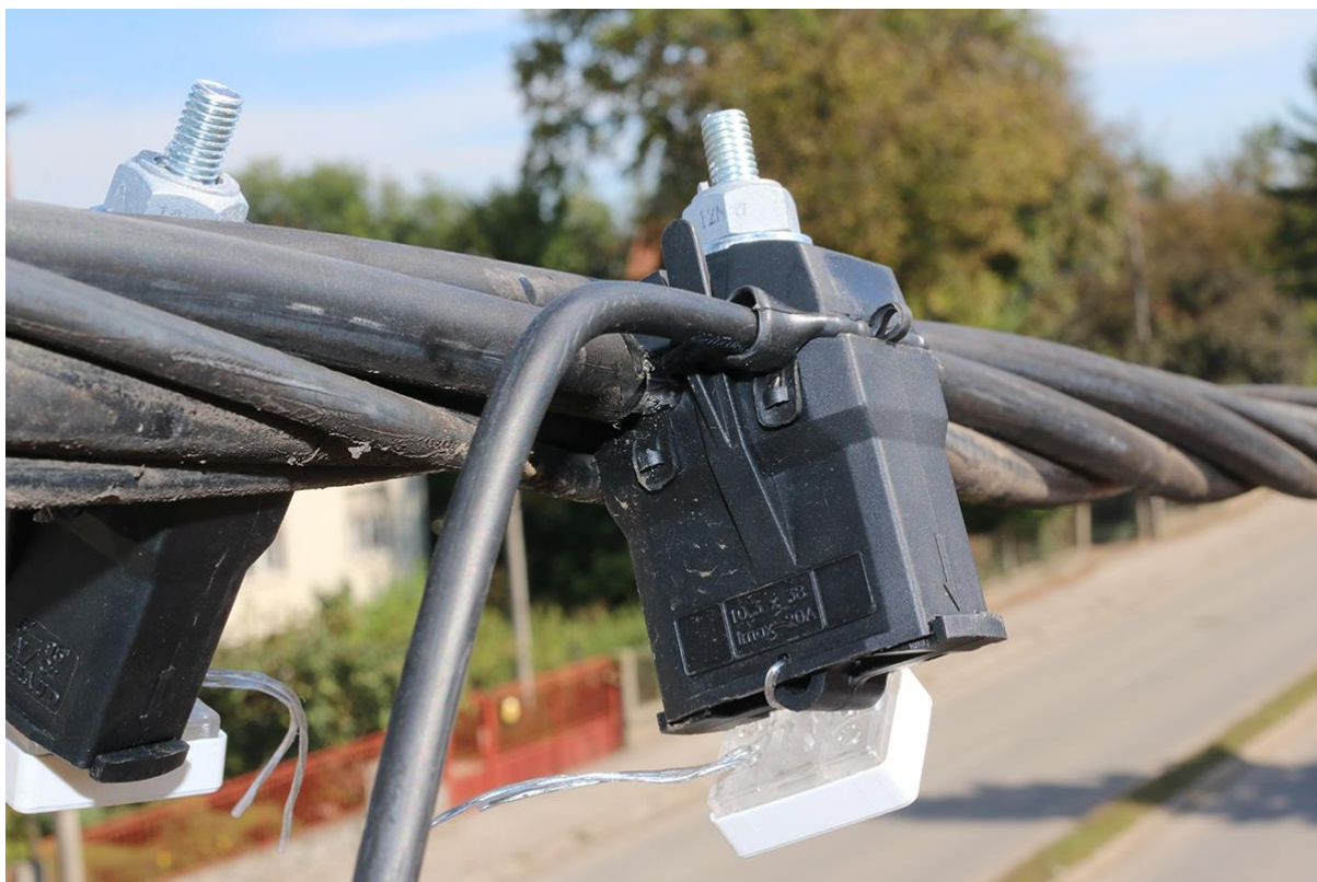
Slika 5 - Stezaljka plombirana KSP plombom evidentiranom kroz zapisnik
