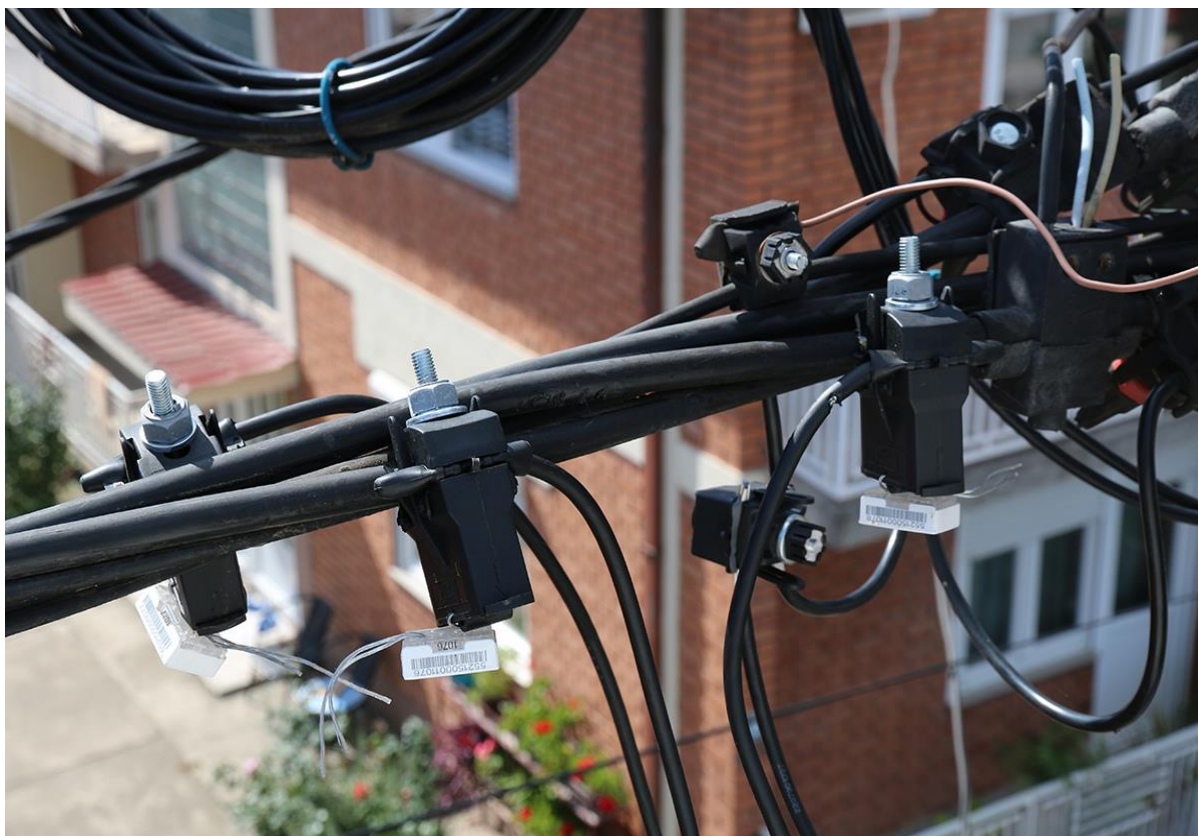
Slika 3 - Primer stezaljki ugrađene na priključku kupca (na fazama)
