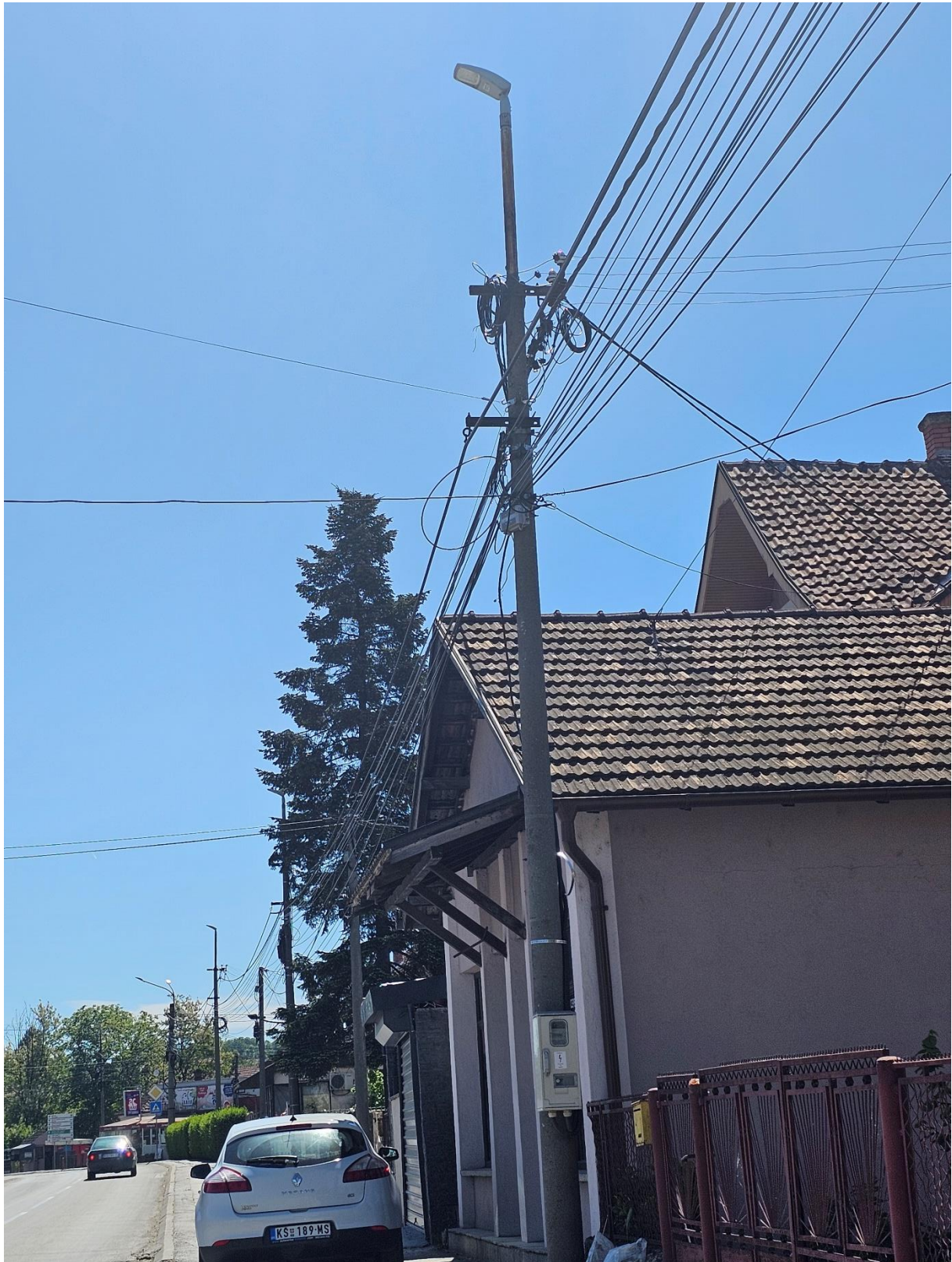
Slika 4 - NN stub sa izmeštenim mernim mestom koje je priključeno navedenim stezaljkama.
