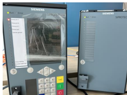
Slika 2 – dodatni releji digitalne transformatorske stanice
