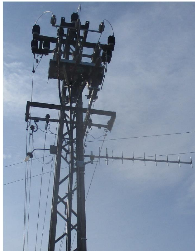
Slika 5 - TK oprema na reklozeru
